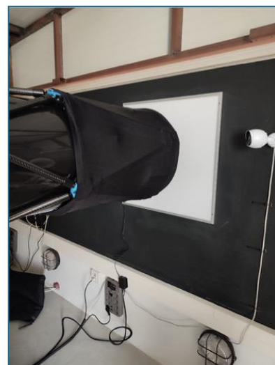
Figuur 32: Ook flats kunnen geautomatiseerd gemaakt worden met een flatpanel tegen de muur gemonteerd.
